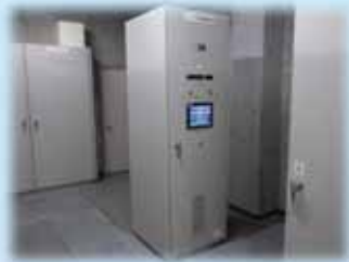
トンネル照明制御盤
