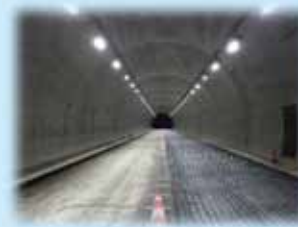
小江尾トンネル下り線 トンネル照明
