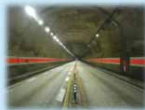
江府トンネル上り線 トンネル照明
