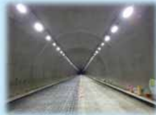
江府トンネル下り線 トンネル照明
