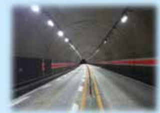
小江尾トンネル上り線 トンネル照明
