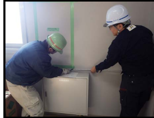
機器設置位置確認（駐車場電源切替盤）
