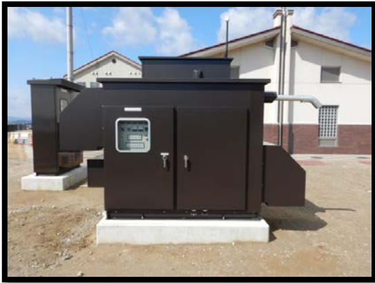
非常用発電機
