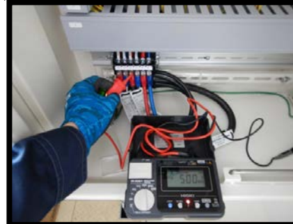
絶縁抵抗測定（駐車場電源切替盤）
