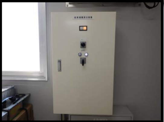
駐車場照明切替盤
