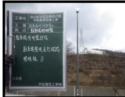
点灯確認（駐車場照明）
