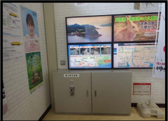
道の駅切替盤
